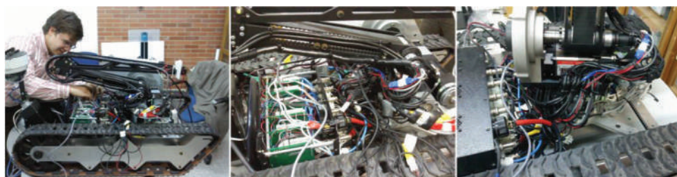
Figura 6 – Conexión manual de los diferentes sistemas en el robot (izquierda). Vista interna de la caja de control de motores (centro). Tráfico de cables que bajan del brazo manipulador a las cajas de control ubicadas en la plataforma móvil (derecha).
