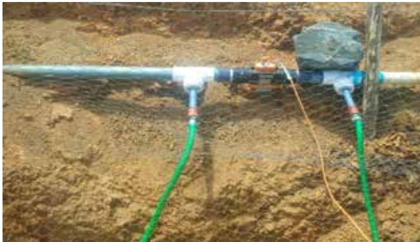
Fig. 1. Imagen del caudalímetro instalado en una línea de inyección.
