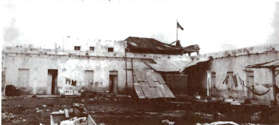
Durante el cardenismo, la Escuela Juárez fue reconstruida y dotada de mobiliario. Años después, cíclicos huracanes la dañaron parcialmente
